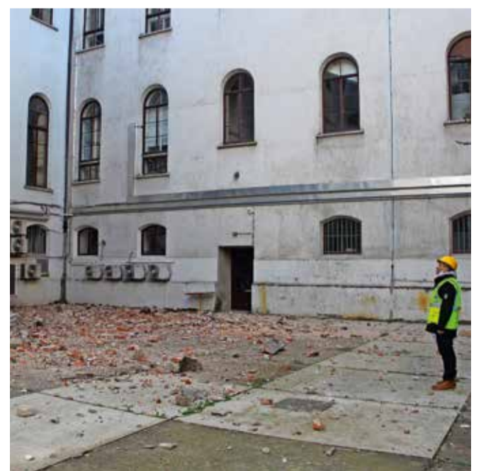
Pregled zgrade Sveučilišta i Pravnog fakulteta u Zagrebu nakon potresa u ožujku 2020. godine
